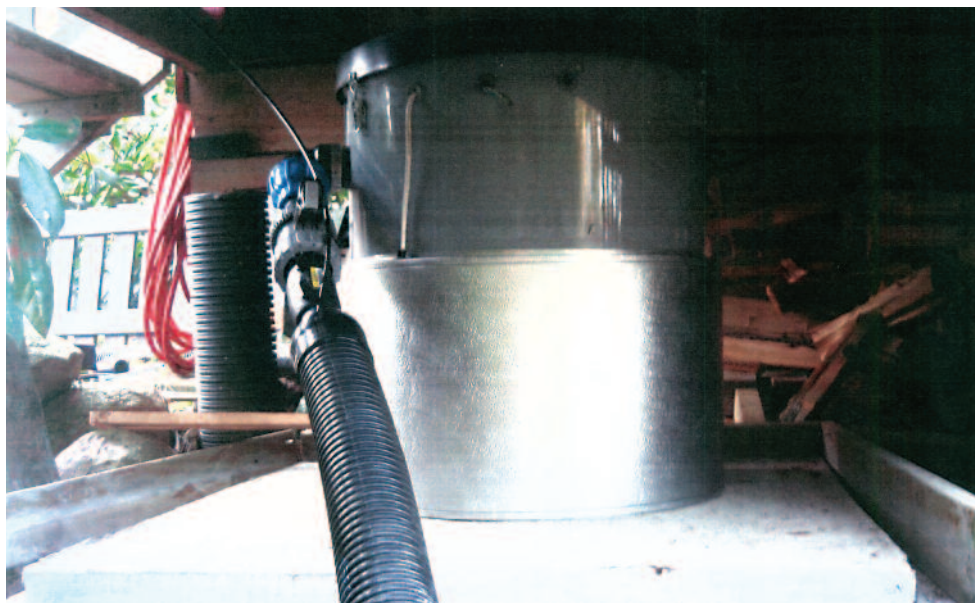
Isolert pumpestasjon plassert under veranda. Foto: Opplandske Rørsystemer AS
