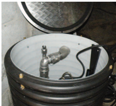
Pumpestasjon plassert i kjeller. Foto: ØP
